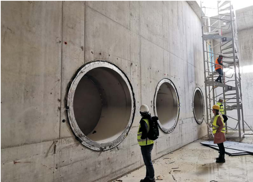
Station de pompage du Vengeron
